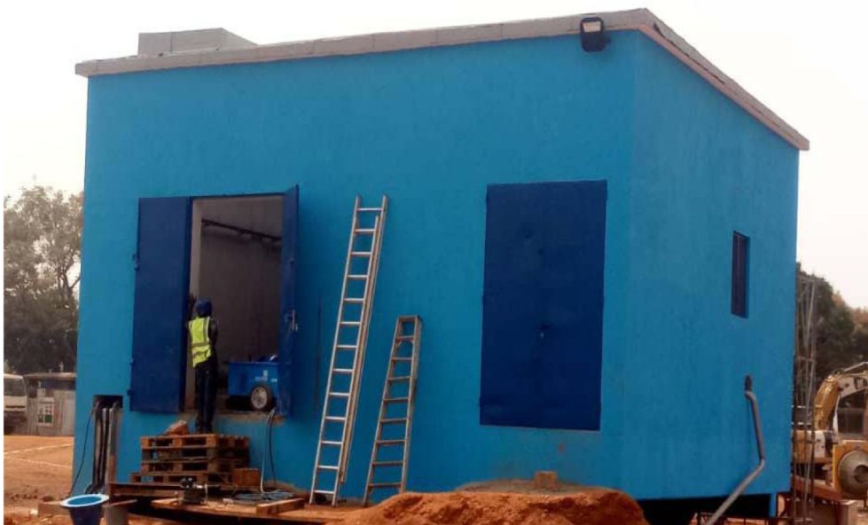
Station de pompage de l'Okpara
